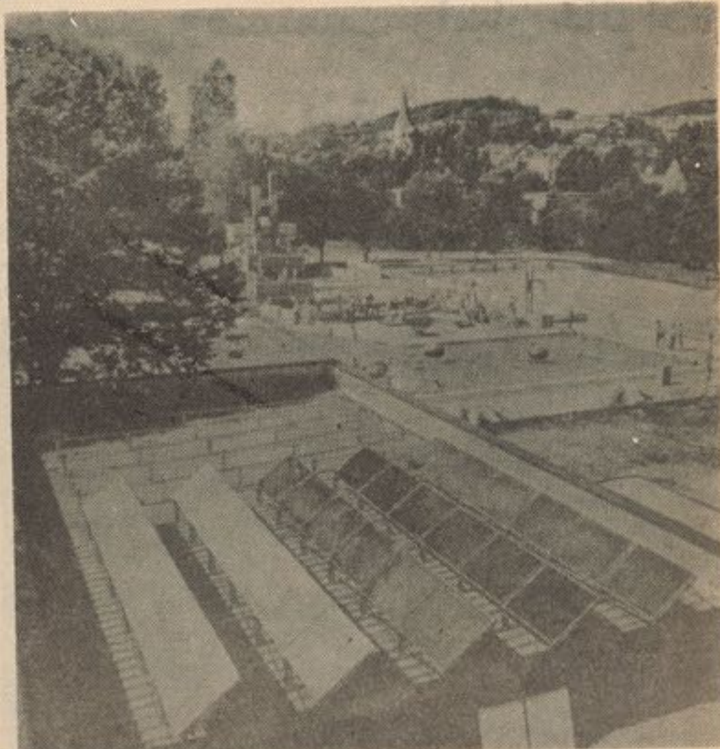
دستگاه های آخذة انرژی آفتاب که در بام ساختمانها تعبیه گردیده و منازل را گرم می سازد
