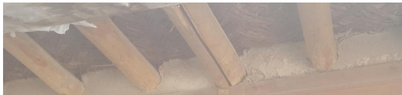
عکس از سقف پیک اتاق بدون مسطح
