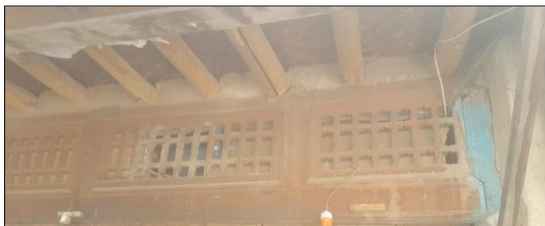
عکس از سقف پیک اتاق بدون مسطح
