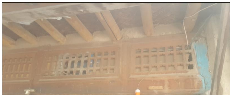
عکس از سقف پیک اتاق بدون مسطح
