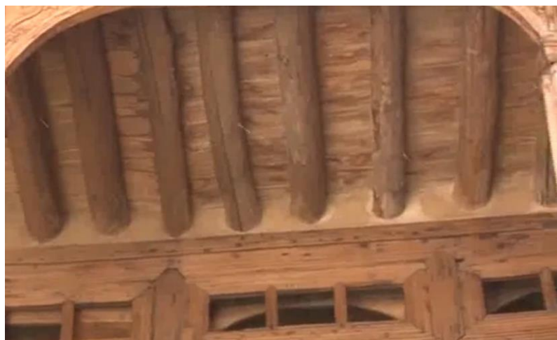
عکس از سقف اتاق بدون مسطح
