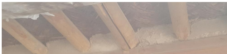
عکس از سقف پیک اتاق بدون مسطح
