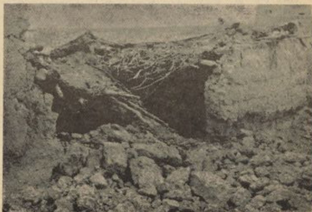
صحنه یی از خرابی زلزله دواشکمش
