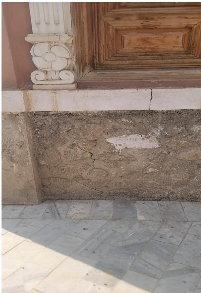
تصویری از ترک عمودی در ساختمان حرمسرا
